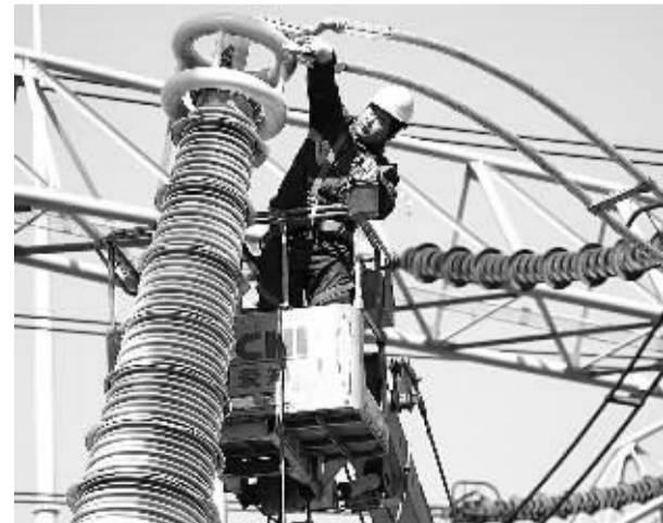
在华北地区,雾霾天气给电网设备安全运行造成不利影响,防污闪成为电网安全重点工作。国家电网河北电力检修公司加强设备特巡,利用秋季检修的机会对绝缘子进行防污喷涂,确保电网安全稳定运行。图为工作人员在沧西500千伏变电站对绝缘子喷涂防污闪涂料。 邹 栋摄
