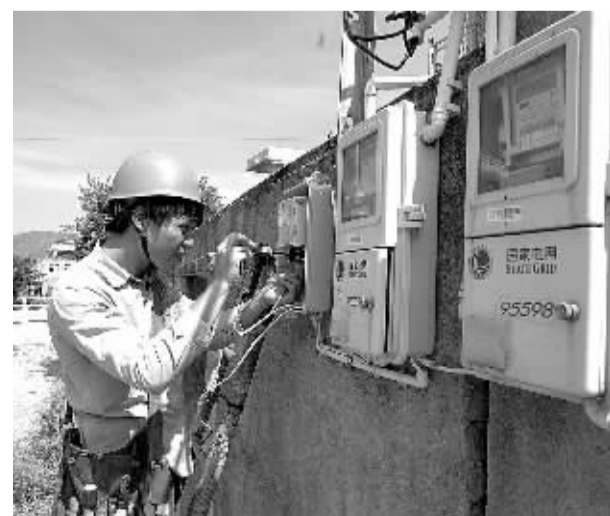
电力工人在浙江省玉环县楚门镇吴家村安装电表智能采集装置。今年以来,为配合老旧村庄的新农村建设,国家电网浙江玉环县供电公司在全县老旧村庄进行新农村电气化建设,无偿帮助村民安装智能电表及信息采集装置,让农村群众也能享受到城里人的用电体验。 陈维摄
