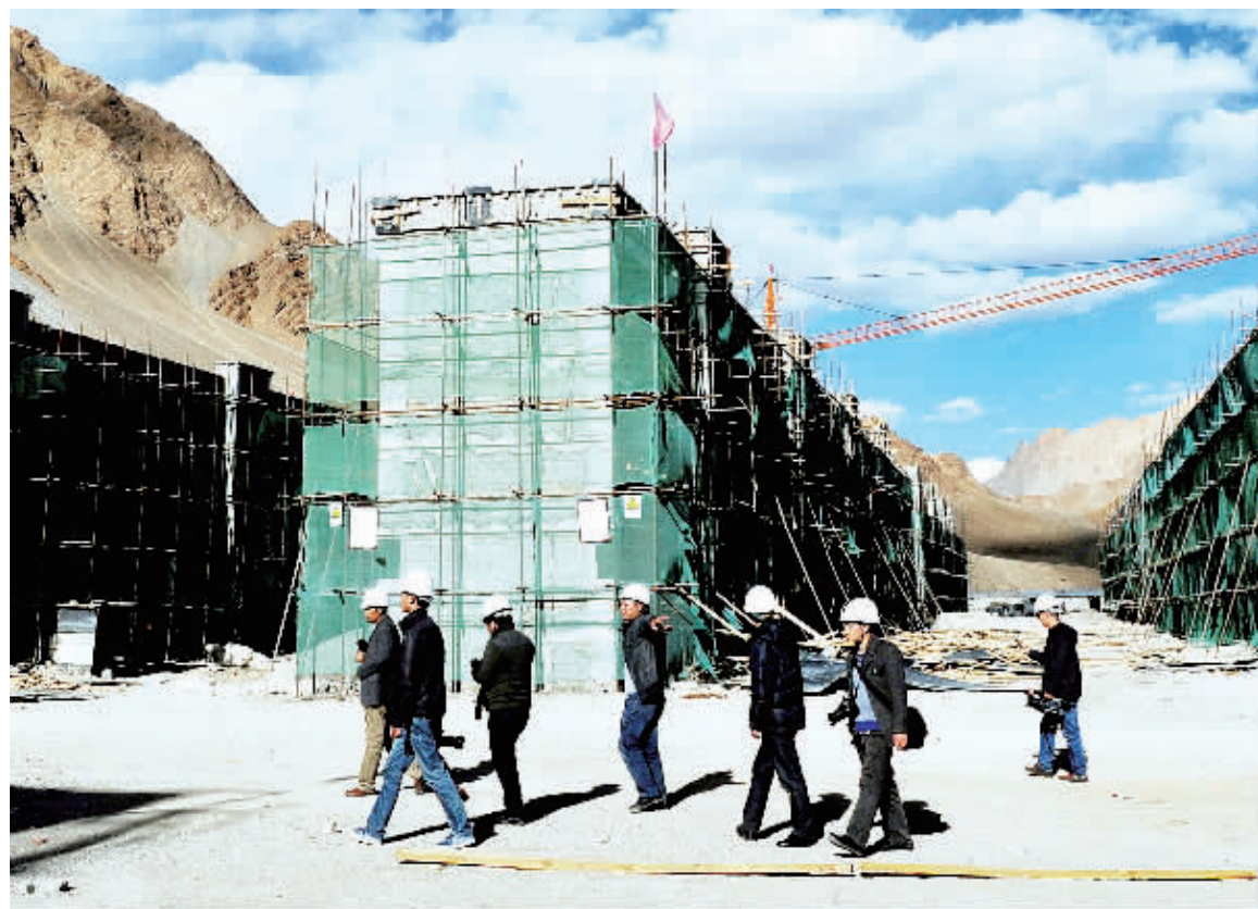
9月25日，工人在西藏阿里狮泉河镇加紧建设公租房。近年来，西藏阿里地区加大廉租房、周转房、公租房等保障性住房建设，2012年至今共建设5973套保障性住房，其中1370套为棚户区改造项目。新华社记者索朗罗布摄
