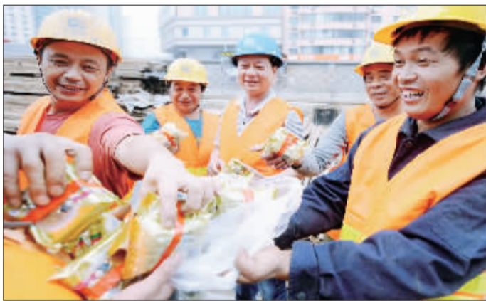
9月19日，北京地铁15号线安立路站施工区，奋战在节日岗位上的中铁隧道集团的员工分享月饼，感受关怀。
