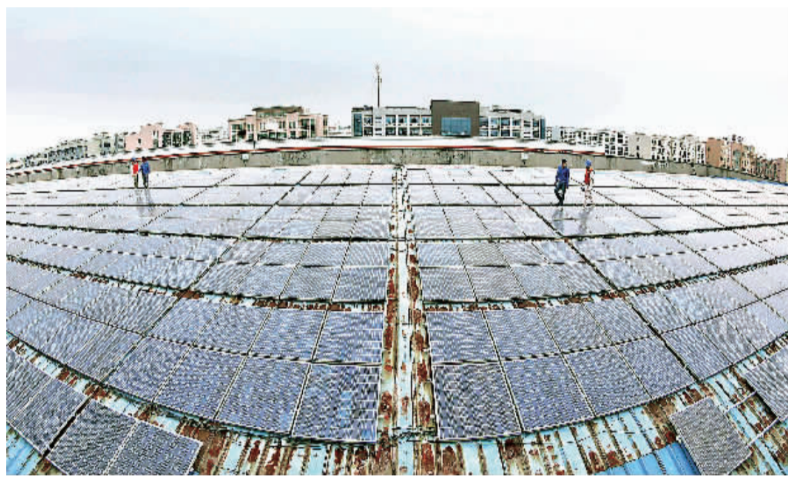
浙江金华永康市供电公司党员服务队队员在巡查一家企业的屋顶分布式光伏电站(9月6日摄)。
