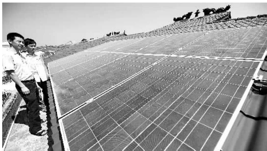
这是江西新余市渝水区罗坊镇湖头村农民李礼玉家屋顶的光伏发电系统(8月8日摄)。
