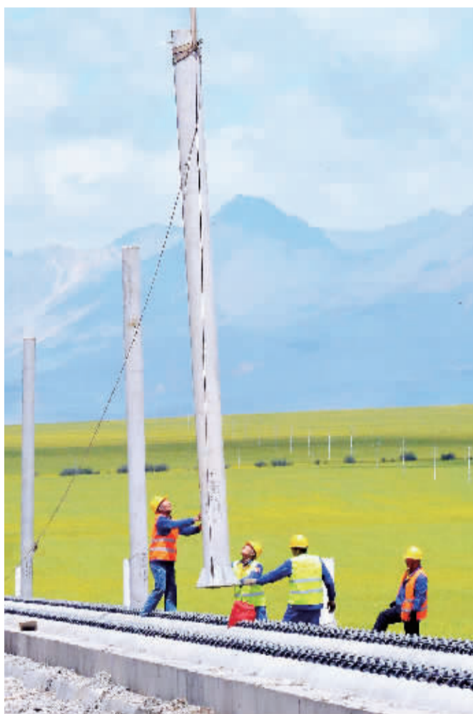
上图 7月28日,在青海省门源县境内的施工现场,工人们正在安装接触网支柱。
