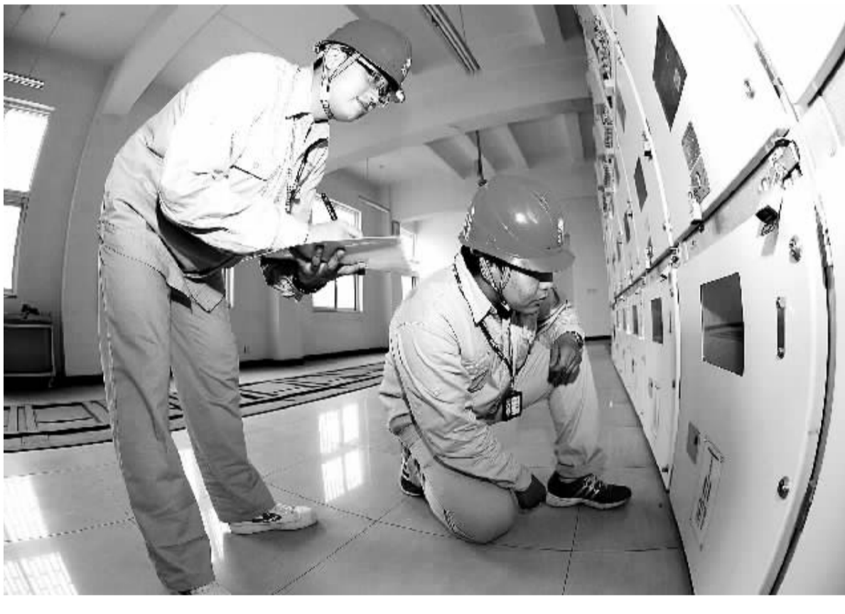
7月6日,河南省郑州供电公司员工对变电站设备进行巡视检查,保证电网运行安全。代锦霞摄
