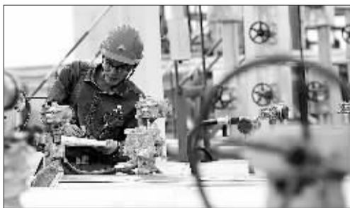
作业队员工邱功兴在巡检设备。该作业队63人轮番上岗,保障了气田安全平稳运行。
