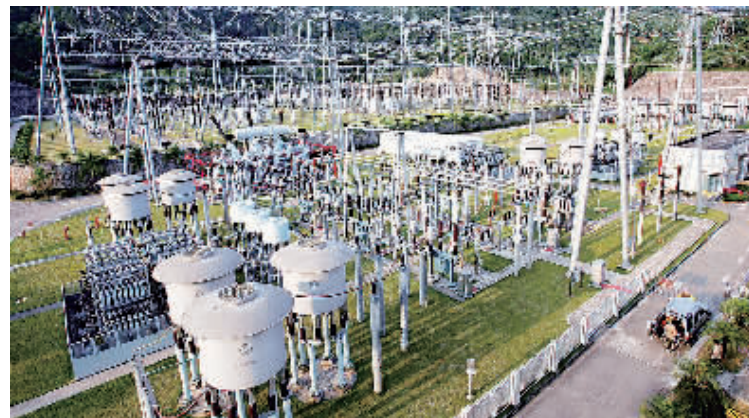
福州500千伏综合自动化变电所。
