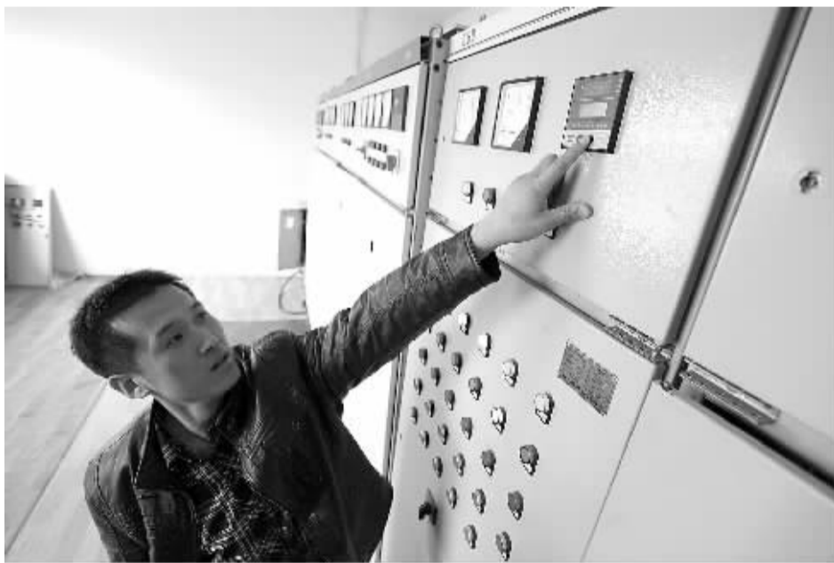
工作人员在河北南宫第四水厂配电室查看配电设备运行情况。 朱旭东摄(新华社发)
