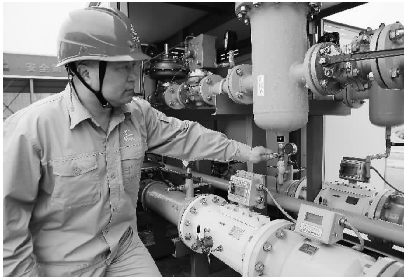
中国石化管道公司以绿色低碳作为发展理念，大力实施生态园输油站场建设，实现清洁生产，如今已成为国内第一个生态园输油企业。图为5月2日荆门输油站员工在检查天然气管线。李诗银摄
