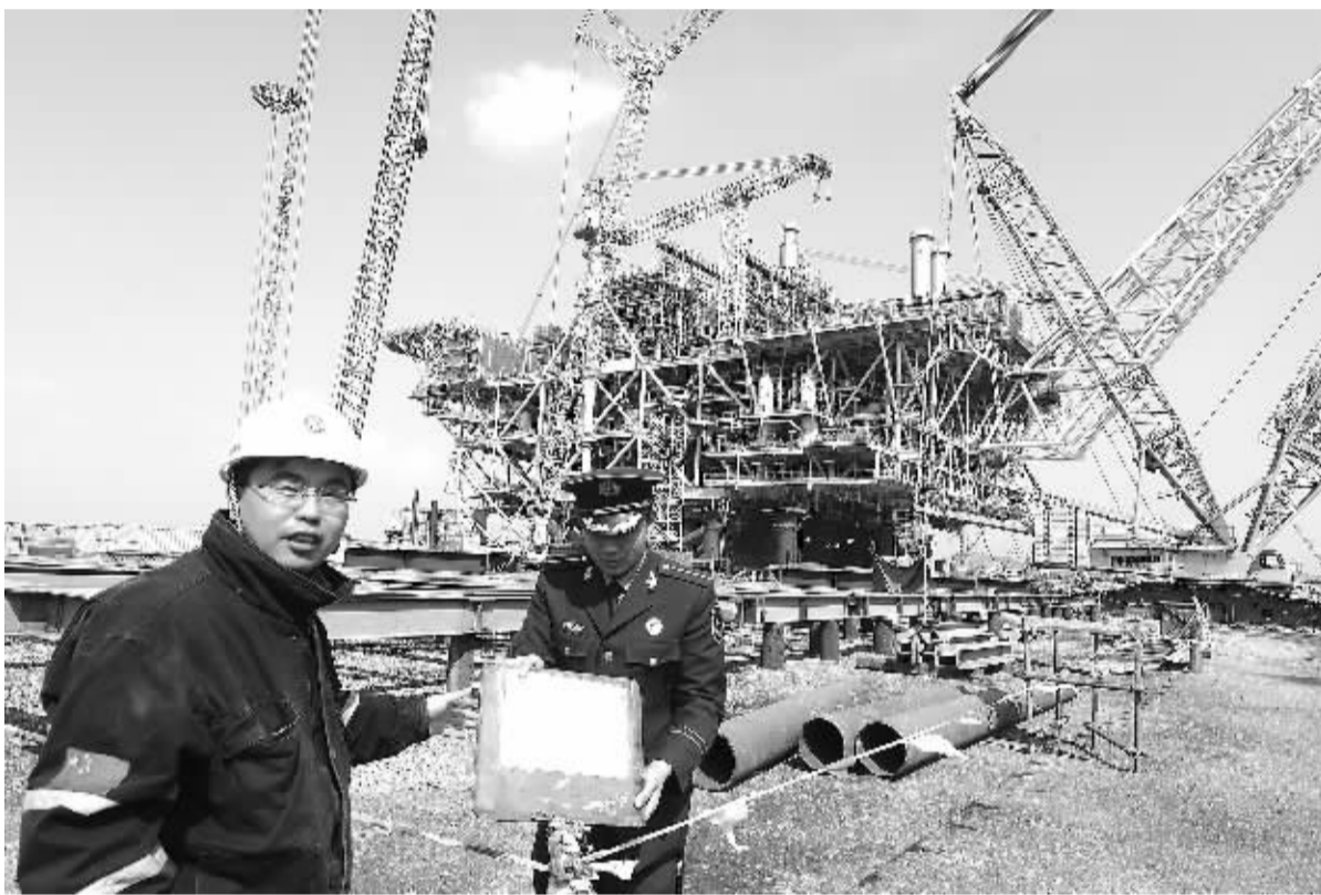
4月9日,我国海上第一个大型深水气田“荔湾3-1”气田中心平台组块陆地建造项目在山东青岛中海油建造基地完工。平台上船调试后将于5月底完成组块浮托,预计9月投入生产。图为黄岛边检站警官在工程现场设立警戒标识,确保平台组块拖上船顺利实施。
