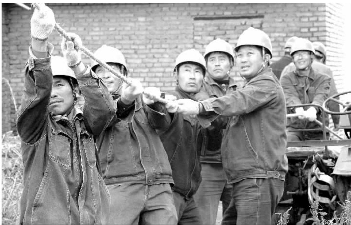
2 月 7 日,安徽省滁溪县供电公司施工人员在韩村镇处理线路隐患。为保证春节期间企业安全生产和居民生活用电,滁溪县供电公司节前对全县电力线路进行了检查和整改。张楠摄
