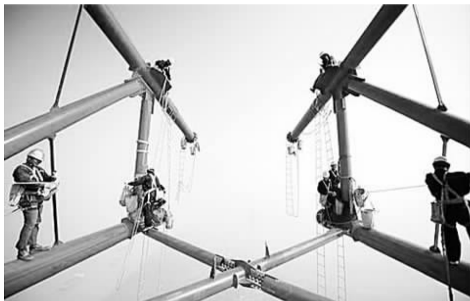
图为世界最高特高压输电跨越塔——我国“皖电东送”工程长江南岸跨越铁塔2012年封顶现场,整个工程计划2013年底建成投运。(新华社发)
