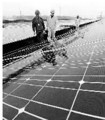
2012年12月27日,绍兴电力局工作人员正在巡查光伏电站。 新华社记者 王小川摄
