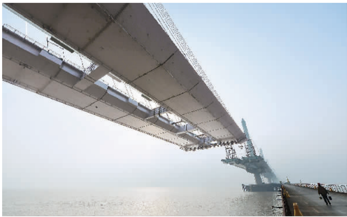
2013年元旦假期期间,杭州湾第二座跨海大桥——嘉绍跨海大桥建设工地上热火朝天,工人们冒着海上大风和接近零度的室外温度奋战在大桥工地上,为早日通车而努力。 图为即将合龙的大桥主航道。 新华社记者 徐 昱摄
