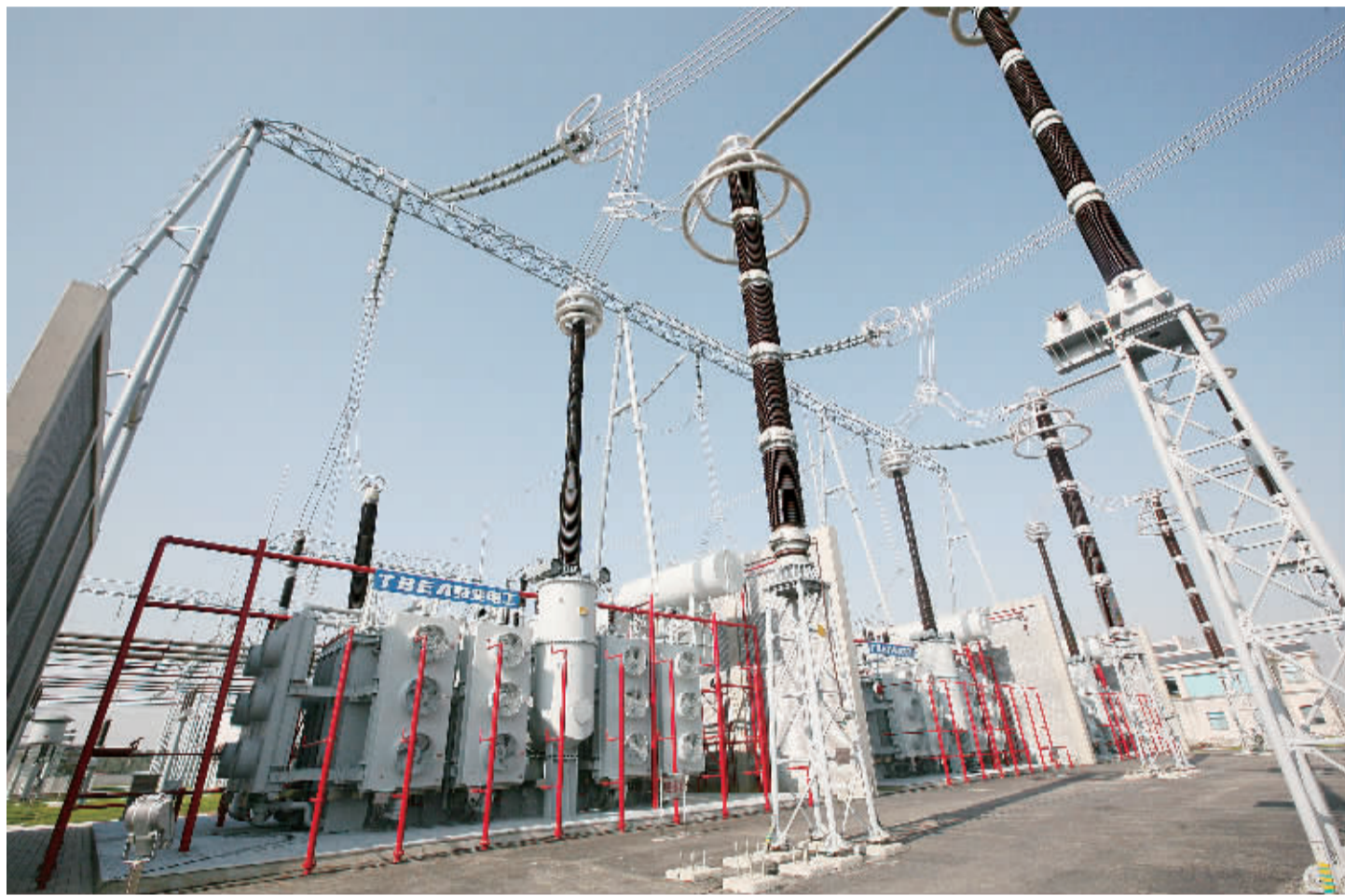
特变电工沈变集团成功研制出世界首台特高压交流1000兆伏安1000千伏变压器,并成功安装在我国首条百万伏输电线路中,填补了国内空白。(资料图片)
