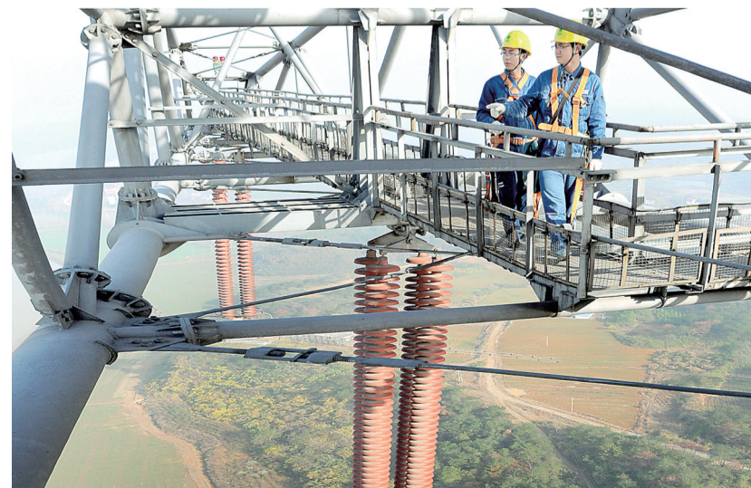
电力部门检修人员在长江大跨越塔上巡检设备。12月12日,锦屏苏南800千伏特高压直流工程正式投入商业运行。该工程线路全长2059公里,额定电压800千伏,额定输送功率720万千瓦,是世界上输送容量最大、输电距离最远、电压等级最高的直流输电工程。本报记者 李树贵摄
