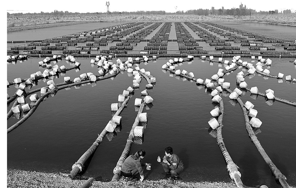
工人在卢龙县龙凤河污水处理厂工作。日前,总投资2183万元的河北省卢龙县龙凤河污水处理厂项目正式投入运行。据介绍,该项目采用生态组合塘+潜流湿地工艺,主要治理纳入水体的农村生产生活废水、畜禽养殖污水和企业外排废水,设计处理废水1.1万吨/日,将有效改善龙凤河水质。
