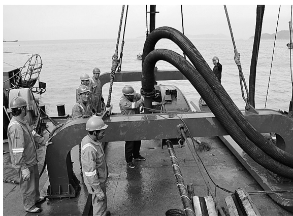
福建电力部门近年来推进边远海岛电力设施建设，解决企业电力不足的困难，提高了海岛供电的可靠性。图为电力部门在霞浦县海岛进行海缆施工。
