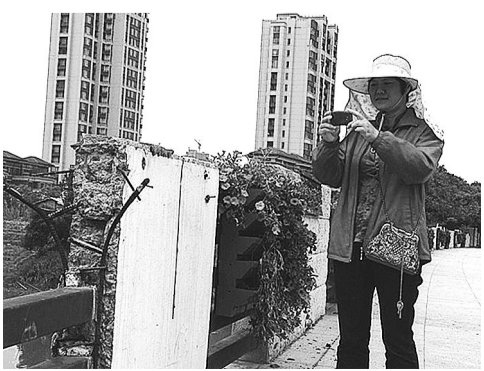
南昌城管信息采集员陶建英正手拿“城管通”,为一处破损护栏拍照。赖薇摄
